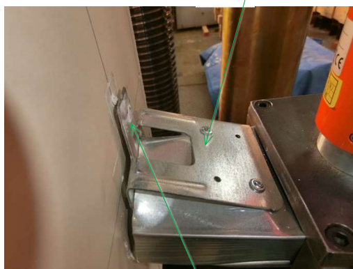
端部固定金具留付用 ビス頭破断
