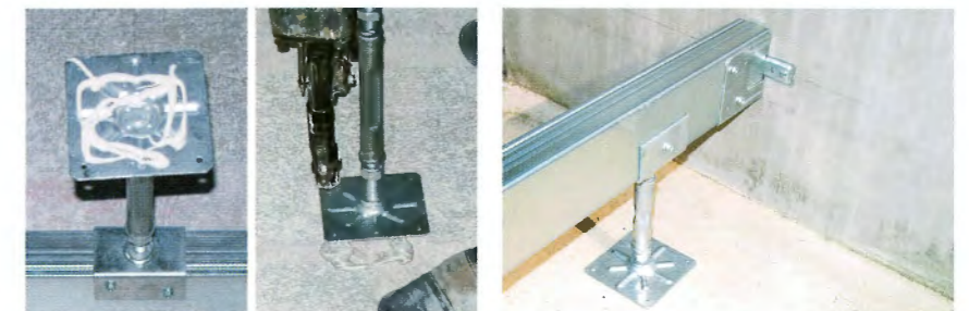
③ 専用鋼製束をコンクリートピンで対角に留める。但し、コンクリート基礎面に不陸や段差がある場合は、ボンドを併用する。 ④ 角型大引鋼をタンゴにはめ込み、専用ファスナーで固定する。
