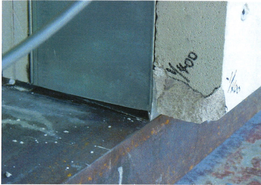
写真-3 試験体の状況 (-1/400rad. : ALC板のはく落)
