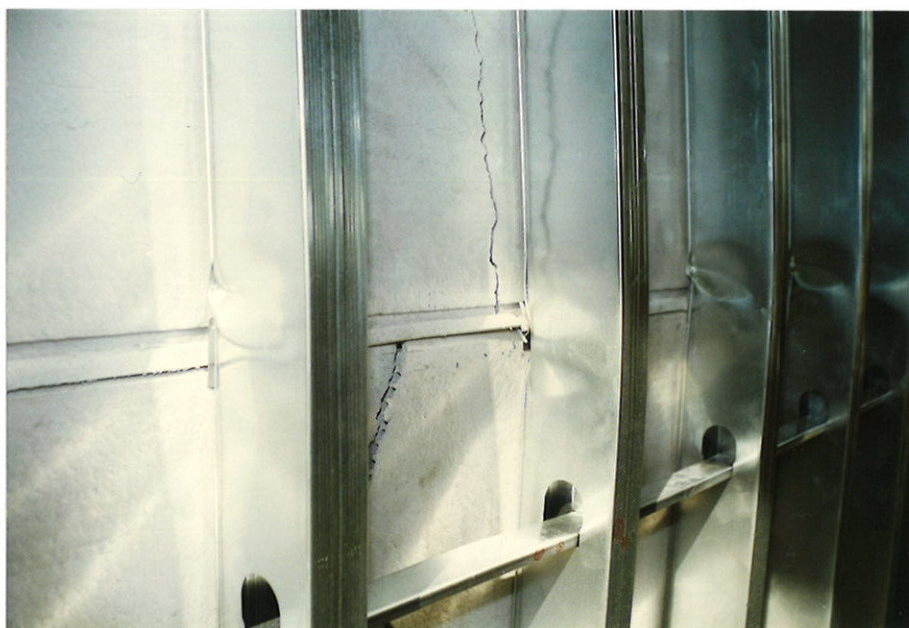
写真-6 破壊状況(屋内側)
