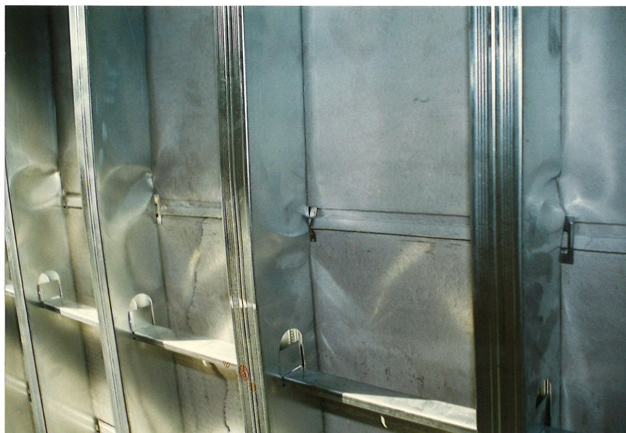
写真-5 破壊状況(屋内側)
