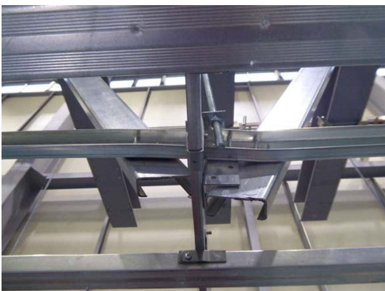
写真-5 試験体の状況 (最大荷重時)
