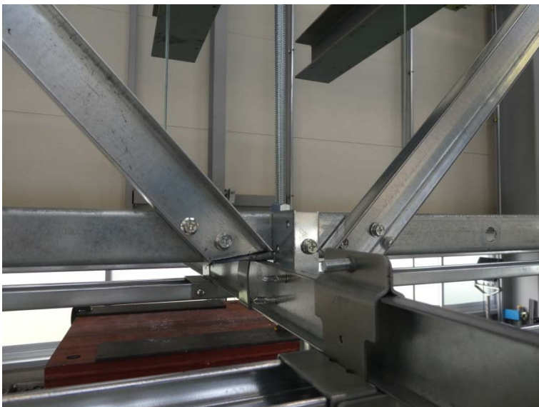
写真-5 試験体の状況（最大荷重時）
