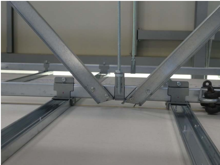
写真－8 試験体の状況（最大荷重時）
